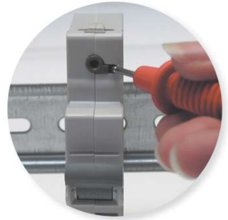
Rys. 7. Kontrola obecności napięcia na zacisku bezśrubowym wyłącznika Etimat 11 QC
